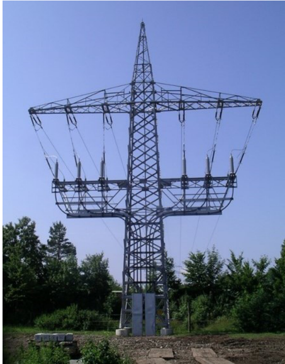
Abbildung 7: Beispiel eines Kabelübergangsmastes
