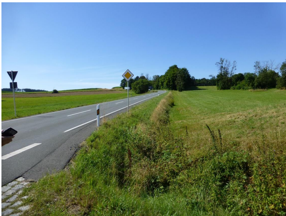
Bild 10: Bestehende Entwässerungsmulde rechts der St 2158 zur Aufnahme des nicht verunreinigten Wassers eines Teiles des Außeneinzugsgebietes A_{E1} (Blickrichtung Marlesreuth von der Einmündung der GVS Am Steinbühl (entgegengesetzt zu Bild 9))
